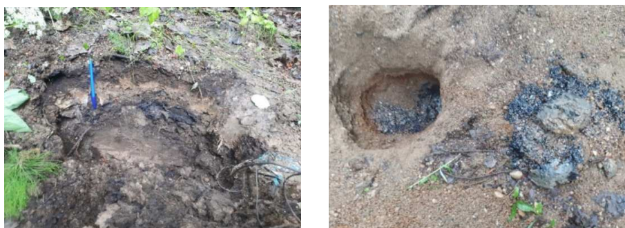
Рис. 3. Визуально определяемые следы нефтяного загрязнения. Слева – прослойки, линзы мазута, битума на поверхности и на глубине около 15...20 см (точка А на рис. 2). Справа – загрязненный нефтью слой грунта на глубине около 50 см под толщей гравия (видимо, отсыпанного для скрытия загрязнения) (точка В на рис. 2).
