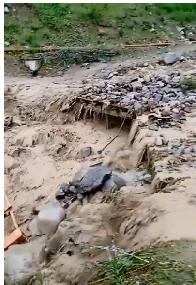
Рис.6. Мостовой переход к альплагерю, перекрытый селевыми отложениями. Автор фото не установлен
