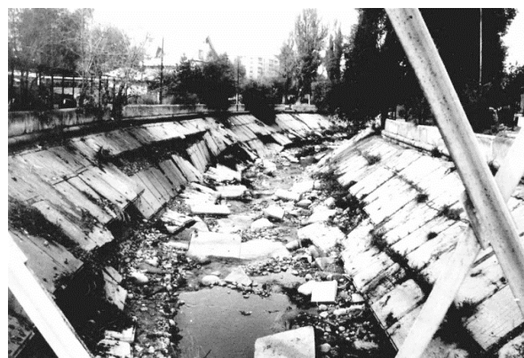
Рис. 9. Разрушение облицовки стабилизированного русла р. Есентай. Фото А.Х. Хайдарова
