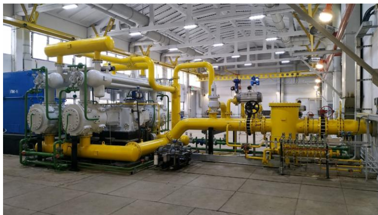
Рис. 2. Новая компрессорная станция ТОО «ПНХЗ».
