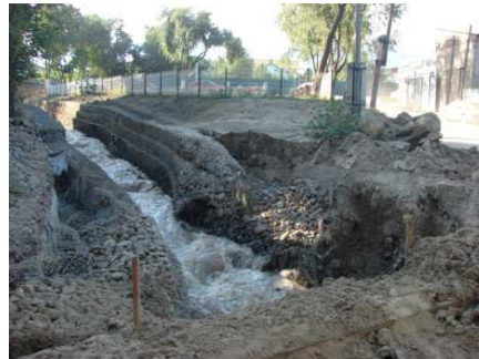
Рис. 7. Разрушение габриона в результате оползания грунта.
