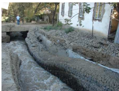
Рис. 8. Разрушение габионов при углублении русла.
