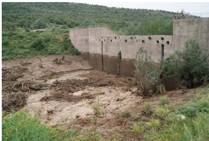
Рис. 2. Следы максимального заполнения селехранилища грязевой массой в бассейне р. Каргалинка.
