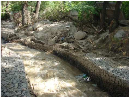
Рис. 6. Разрушение габрионов под действием центробежной силы.
