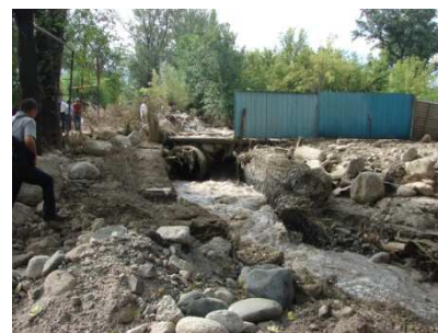
Рис. 9. Разрушение габионов в результате движения селя по их поверхности.
