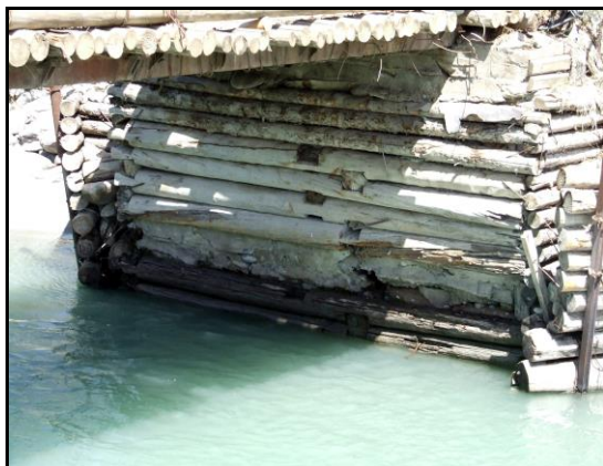
Рис. 1. Опора моста, поврежденная водоледовым селем.
