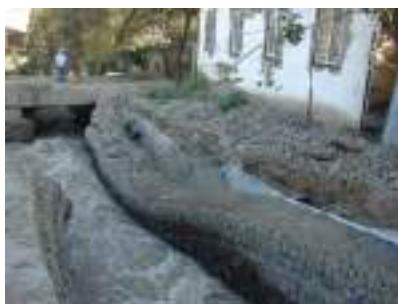
Рис. 8. Разрушение габионов при углублении русла.
