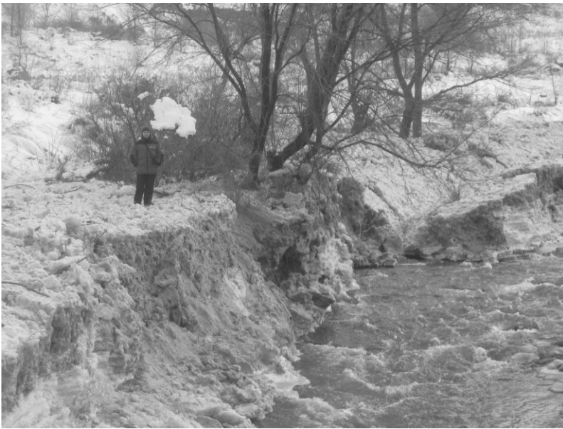
Рис.5. Снежноледовые отложения (мощностью более 3 м) в верхнем бьефе плотины.
